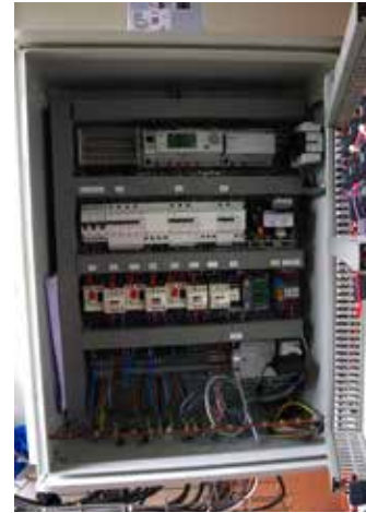
MISE EN PLACE D'UNE G.T.C. (GESTION TECHNIQUE CENTRALISÉE) AU RESTAURANT SCOLAIRE
